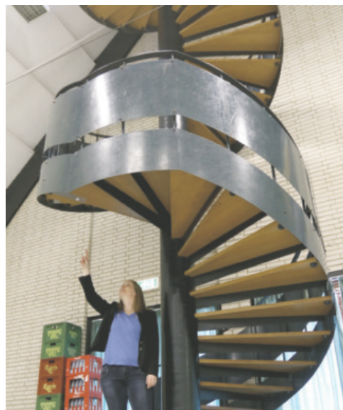
Egetræsplankerne i vindeltrappen i sportshallen er også begyndt at slå revner. FOTO: CLAUS HANSEN
