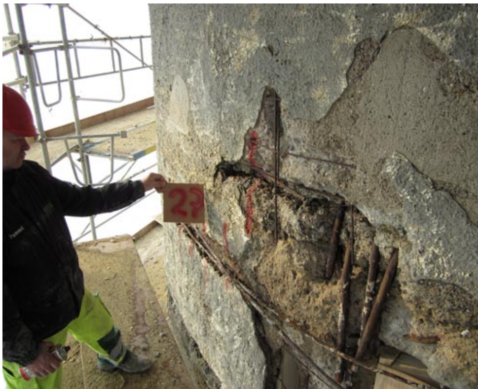
Armeringsskade i et af de otte søjler som holder selve tårnet, samt skade i armering i tværgående betondæk. Den ydre betonvæg på dette sted kun er ca. 7-8 cm tyk.
