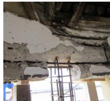
Skaden i den øverste ringbjælke inden renoveringen, og fugt i trækonstruktionen.
